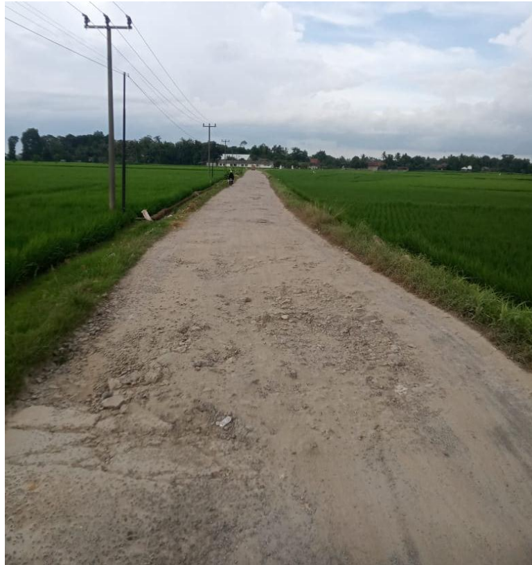
Gambar 4.3 Kondisi jalan rusak di jalur penghubung antar desa di Kecamatan Trimurjo yang menjadi objek pengamatan langsung. Tanggal: April 2025 | Lokasi: Jalan Penghubung Desa Seputih Jaya dan Karang Anyar, Trimurjo
